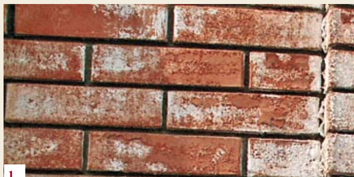
1 Результат солевой коррозии на фасаде: ровные розовые участки — неразрушенная поверхность керамического кирпича, темные полосы — отшелушивание лицевого слоя, белесые пятна — высолы
