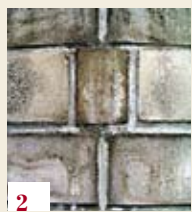
2 Стена из известняка ничем не защищалась (потемнение, вызванное химической коррозией, и следы плесени на камне и в швах)
